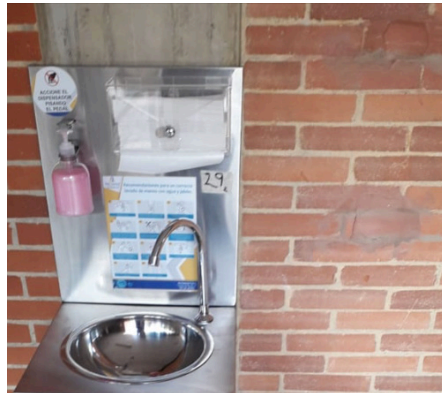
Figura 10.6. Lavamanos + Contenedor de residuos
